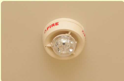
誰でもトイレの天井に設置された フラッシュライト
