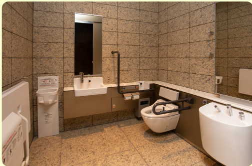
広いスペースを確保し、 快適で使いやすく配慮された誰でもトイレ
